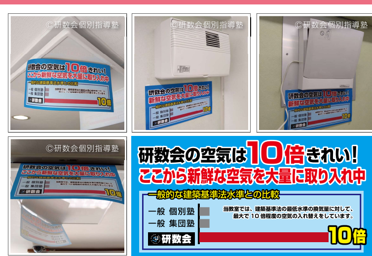
高性能の給排気システム
